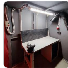
Освещение и вытяжка
